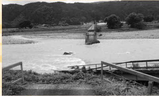
▲崩落した中島橋
