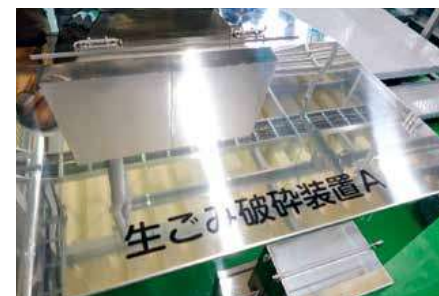
受入室。専用バケツで回収された生ごみが搬入され、生ごみ破碎機で細かく粉砕される
