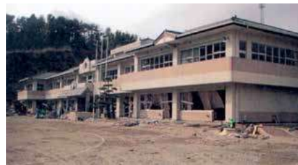
2階床上20cmまで浸水した名足小学校の校舎
