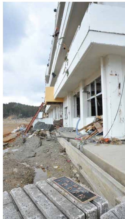
全壊した戸倉小学校
