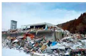
全壊した南三陸消防署歌津出張所
