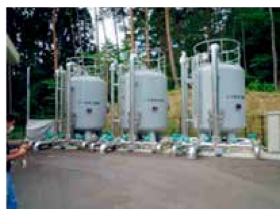
急速ろ過設備
