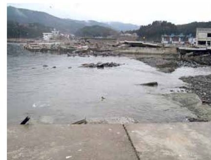
防潮堤の被害(折立漁港)
