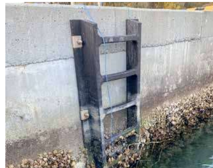
漁業集落防災機能強化事業で整備した弾性梯子(平磯漁港)
