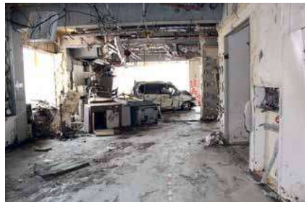
病院内部の被災状況
