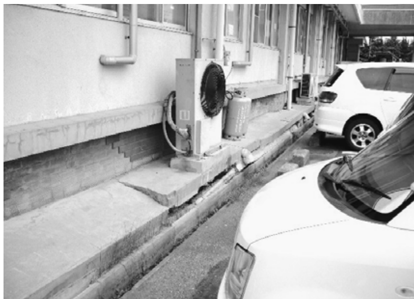
▲ 老朽化部分の改修を
