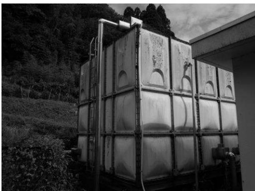
図．FRP製浄水池兼配水池
