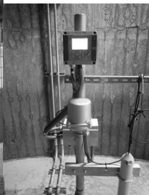
図. 取水井内 原水濁度計
