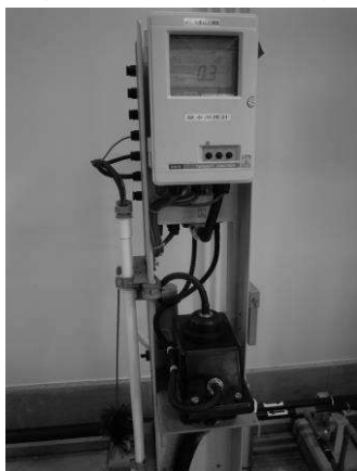
図. 原水濁度計
