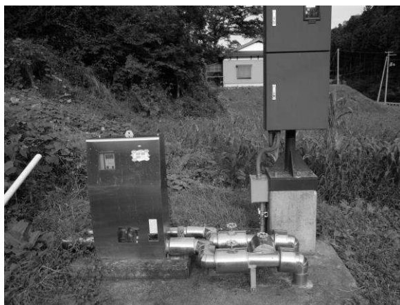
図. 下保呂毛増圧ポンプ場
