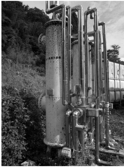
図．急速ろ過機
