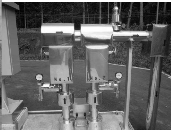
図. 排水ポンプ設備
