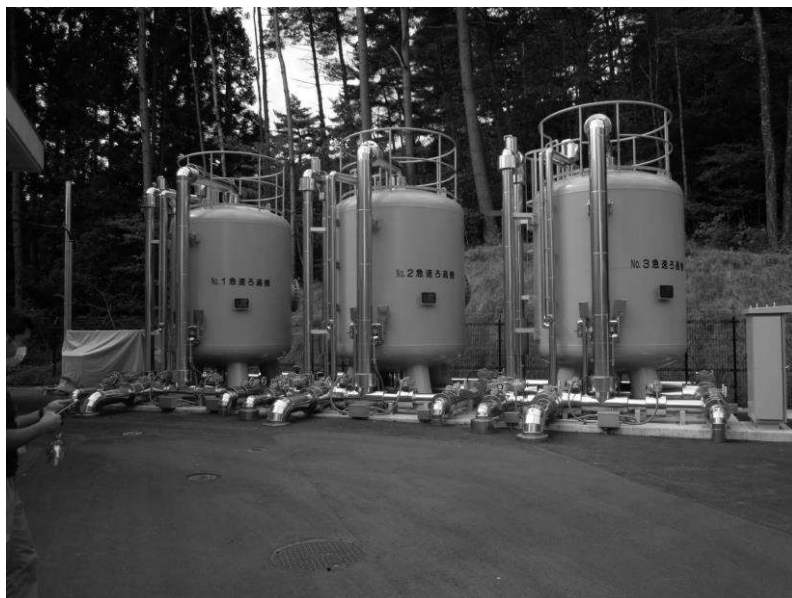
図. 急速ろ過設備
