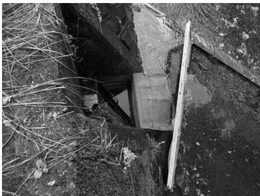
図. 原水取水口
