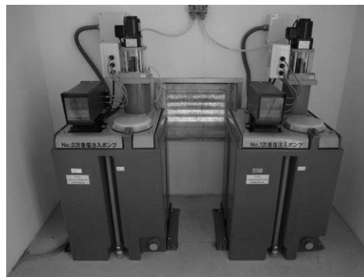
図. 塩素注入装置 1 号 2 号
