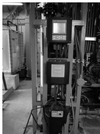
図. ろ過出口濁度計
