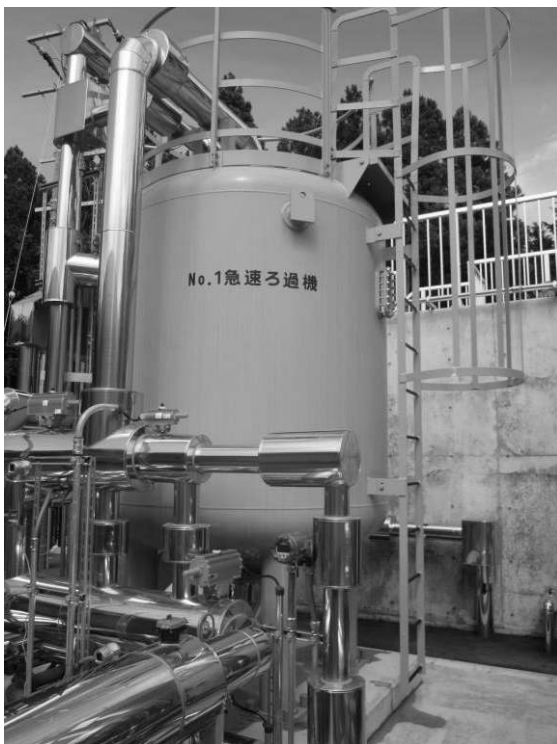
図. 急速ろ過機
