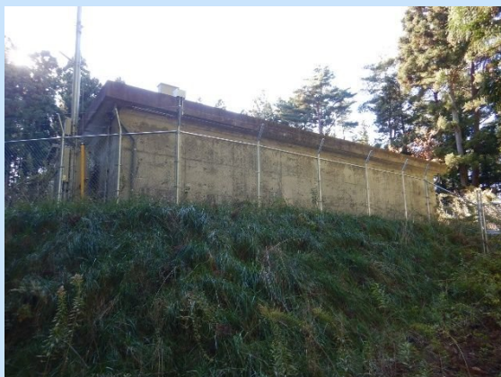
上の山配水池 (1,200m 3 )
