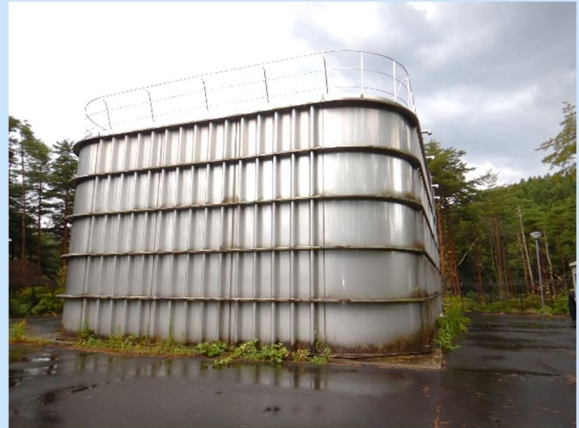
新戸倉配水池 (1,300m 3 )
