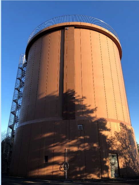
東浜配水池 (2,500m 3 )
