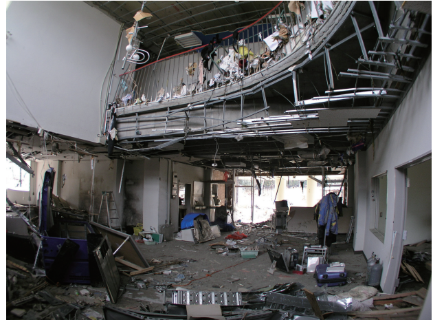
図3. センター内部の被災状況。1階の実験室では(写真の左奥)、標本類は保管していた棚もろとも流失した (2011年4月7日撮影)。
