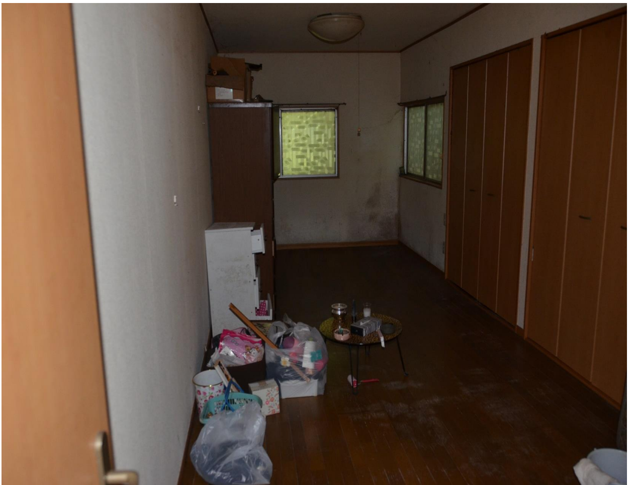
1階洋室 床の張替え必要
