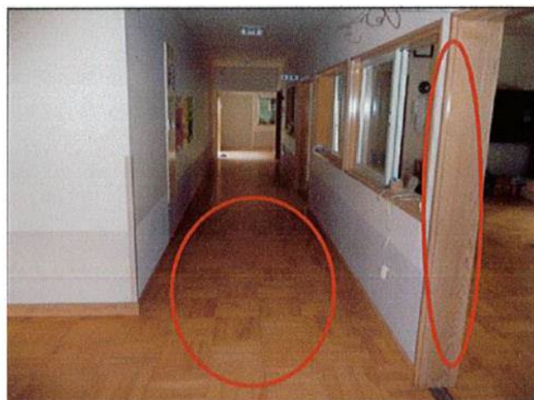
②施設内は床上浸水
