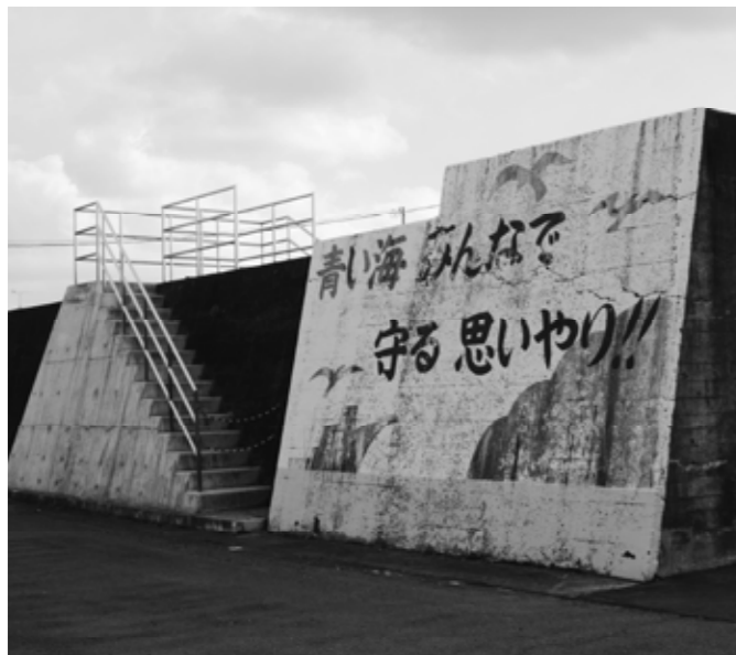
▲ 防潮水門にある避難階段
