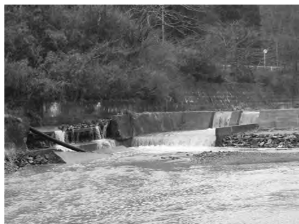
倒壊してる取水堰・早期対応を
