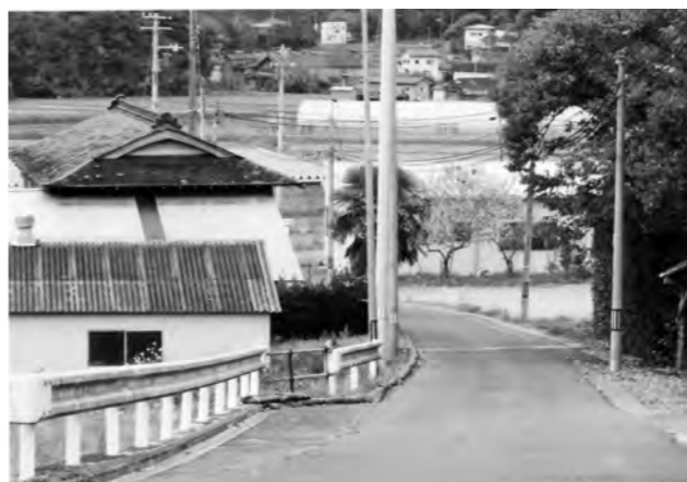
工事が中断している指定避難道路
