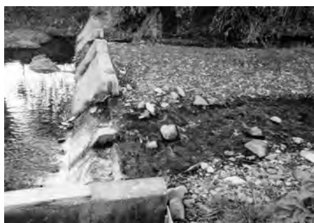
7月豪雨被災した頭首工の現況
