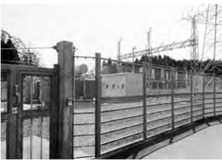
志津川全域と入谷地区の送電を守る志津川変電所
