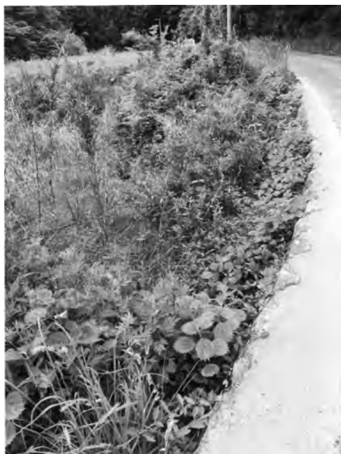
草木を除去すれば急な崖、夜間走行するには極めて危険箇所
