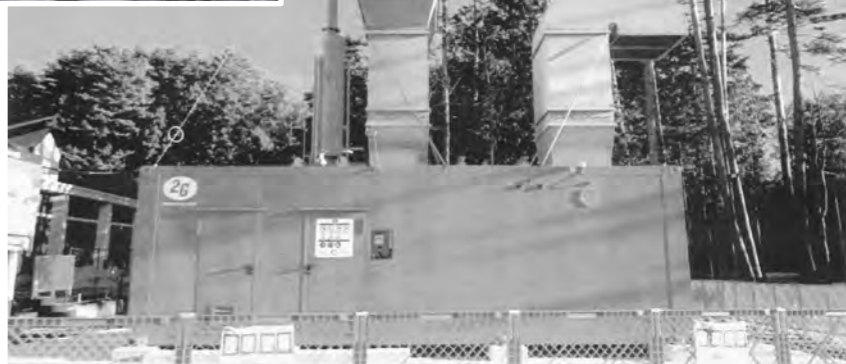
2022.4.6 稼働開始した水素発電所
