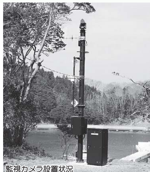
監視カメラ設置状況
